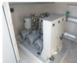
給水ポンプと交換部品
